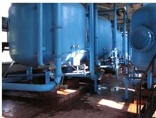
Рис. 1 Технологическое оборудование установки
